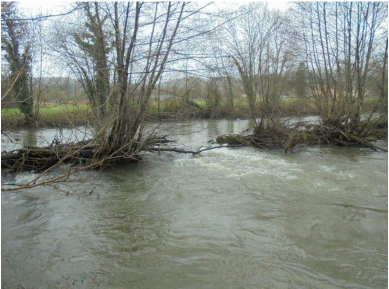
Barrage en mauvais état, mais un débit important alimente encore le moulin
