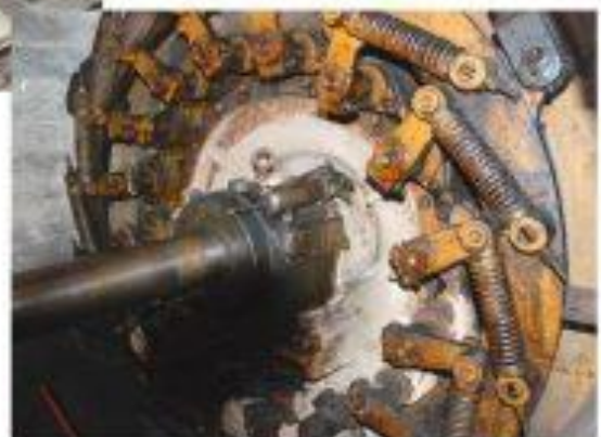
Turbine Kaplan Constructeur DUMONT
